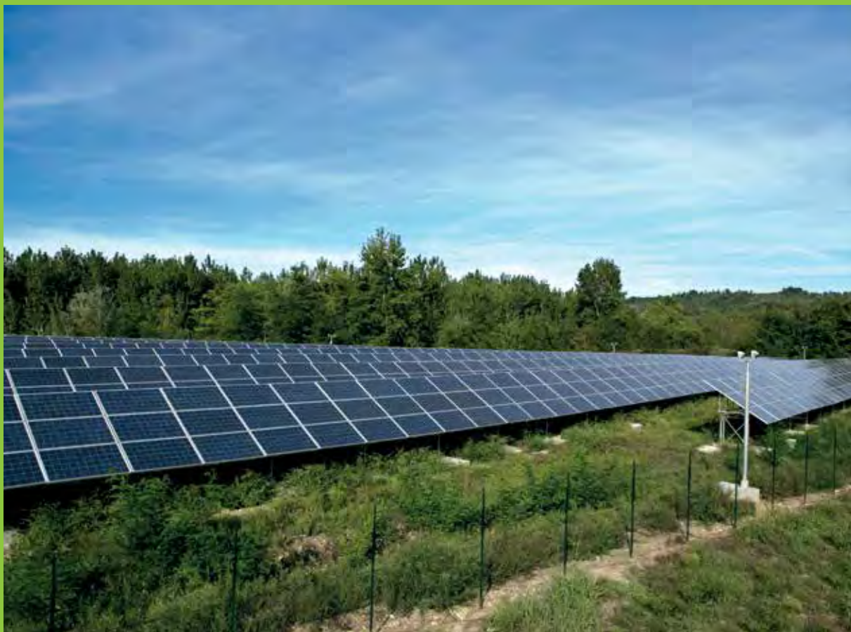
Impianto fotovoltaico Principi di Acaja, di Fossano, che fu realizzato nel 2010 su una discarica di inerti
