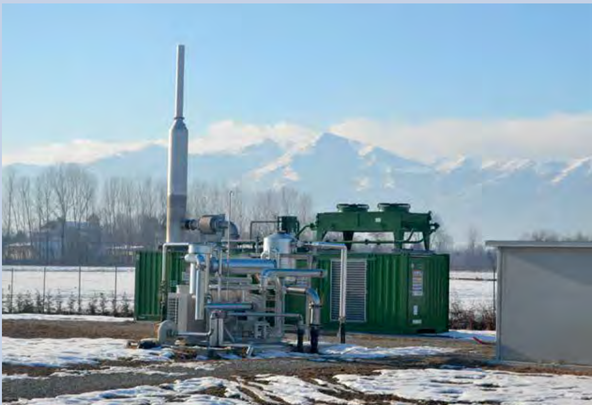
impianto Biogas di Ozegna (TO)
