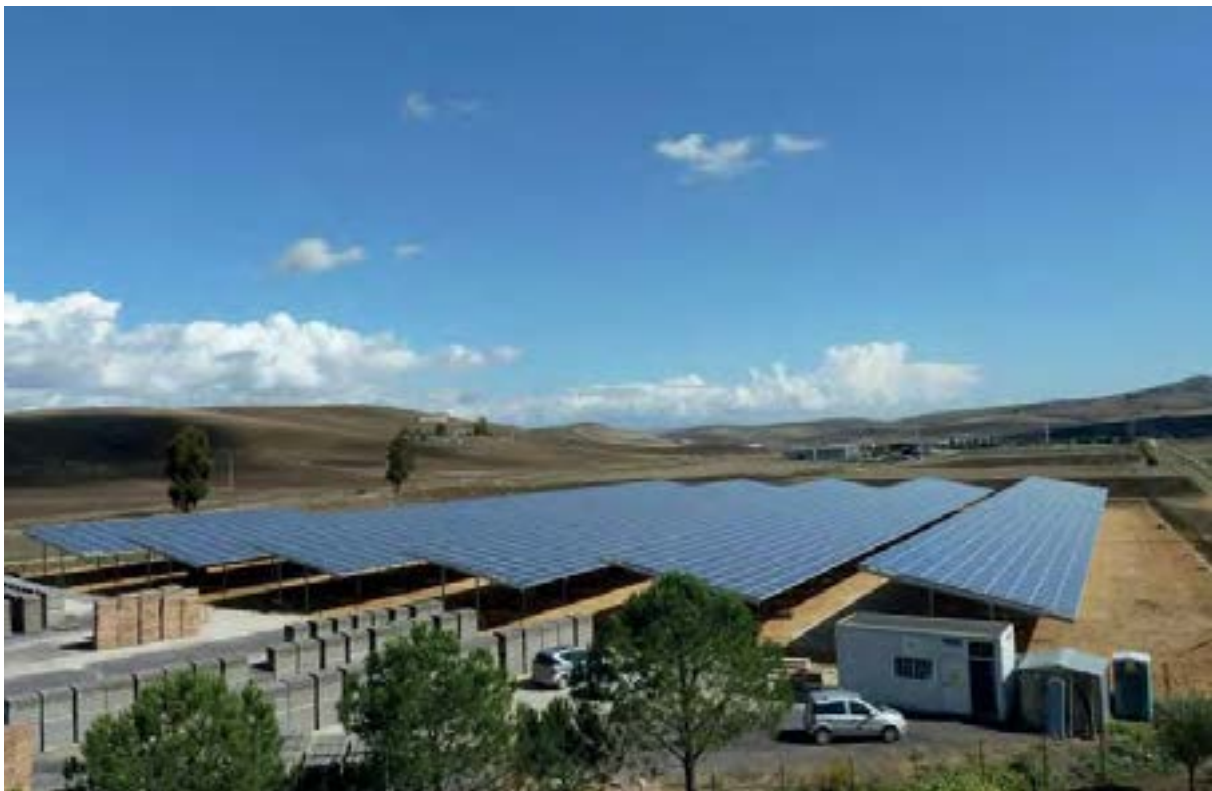
Il Gruppo EGEA ha realizzato all'inizio degli anni 2000 un impianto fotovoltaico ad Enna totalmente integrato sulle pensiline per il posteggio delle auto dello stabilimento "Laterlite", tra le prime aziende produttrici di argilla espansa in Italia
