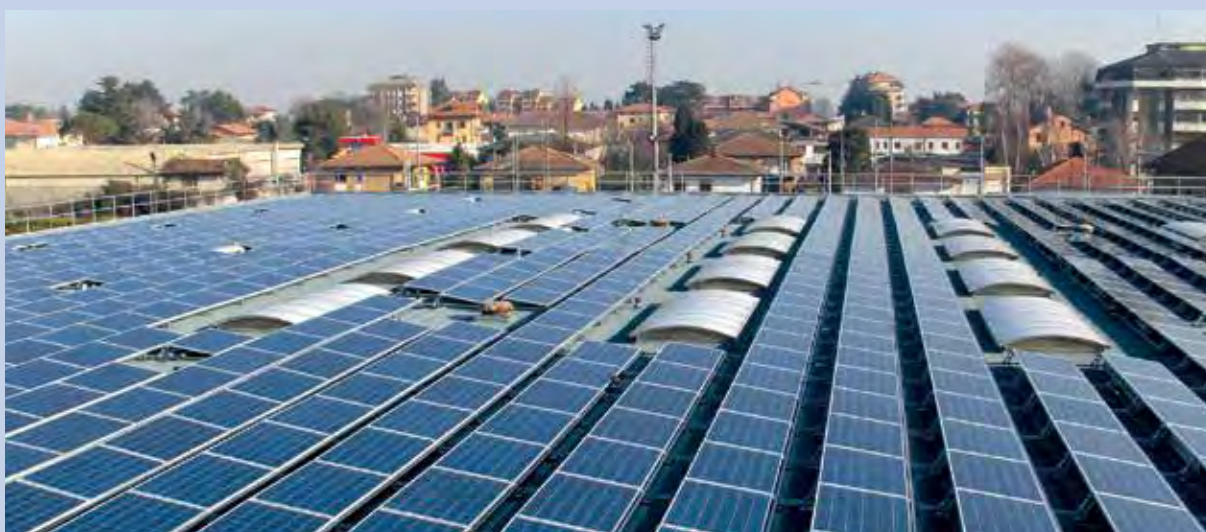
Impianti fotovoltaici montati sulla copertura dello stabilimento "Beldi" di Oleggio (NO)
