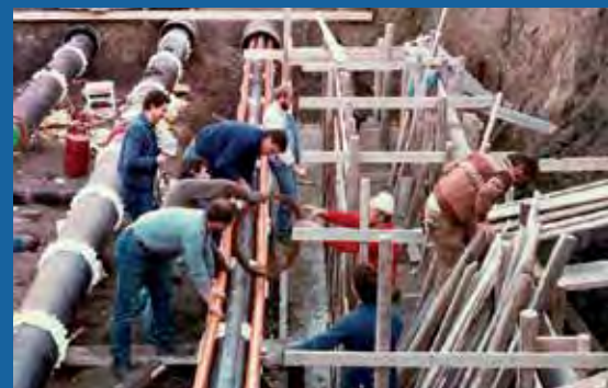
Lavori di trivellazione presso la ferrovia all’altezza di via Vivaro per la realizzazione delle tubazioni del Teleriscaldamento a servizio dell’ospedale di Alba: il primo e pionieristico Impianto della città
