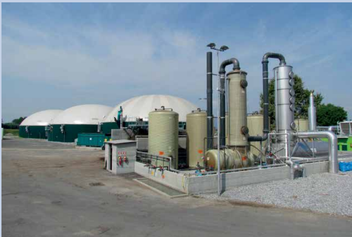
Impianto Biogas di Vottignasco (CN)
