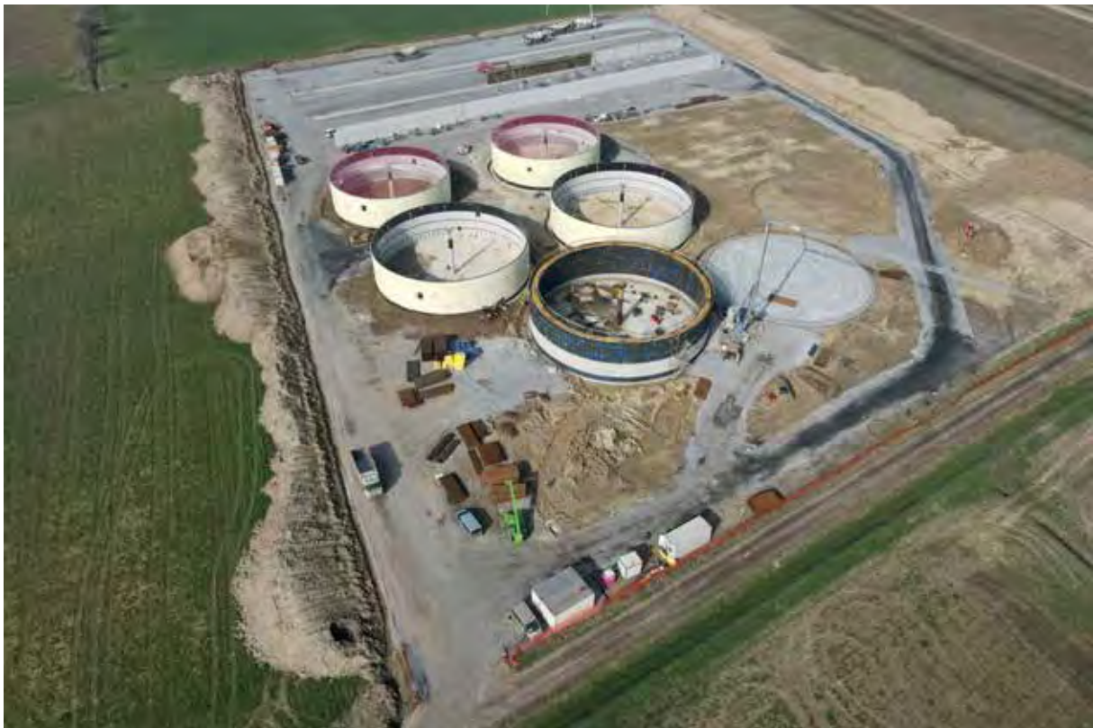
Cantiere per la costruzione del nuovo impianto di Biometano di Cella Dati (CR)
